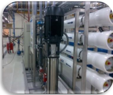
Lắp đặt màng RO RO Membrane installation
